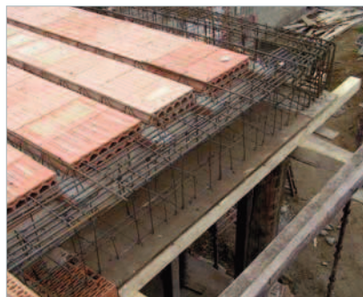
nápojení na průvlak u rohového okna bez sloupku
