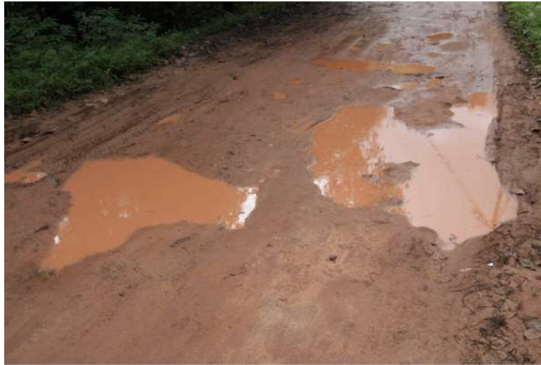
Foto 7. Permukaan Jalan Yang Tidak Rata dan Berlopak
