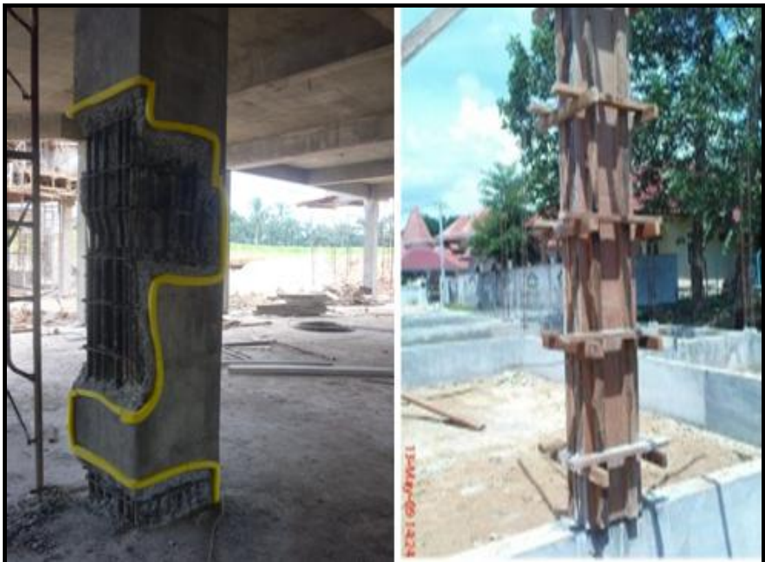
Rajah 2.1 Honey Comb terjadi disebabkan kotak kayu yang mudah rosak semasa kerja konkrit dilakukan
