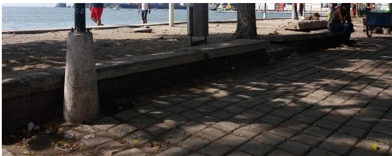
Figura 5. Pavimento articulado. Utilizado principalmente en parques y sectores en los cuales no se tiene un tránsito representativo en vehículos de carga. Por A. Lasso, 2017.
