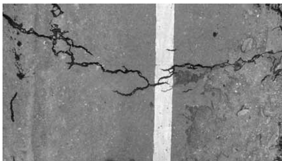
Fig. 6 Imagen con grieta y marca de señalización
