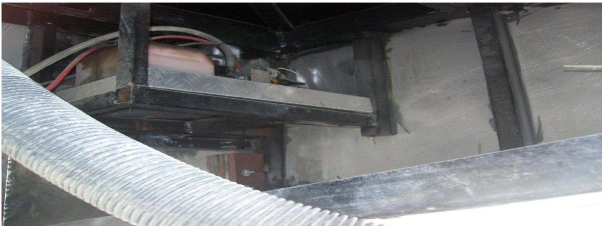
Figura 49: espacio de instalación baterías
