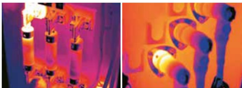
Figura 6.4. Análisis termográfico en sistemas y conexiones eléctricas. Adaptado de (ALAVA INGENIEROS, 2011)
