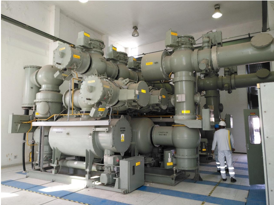
Figura 8.3 Subestación 20 de julio por 110 kV. Por Electricaribe S.A. E.S.P., 2018.
