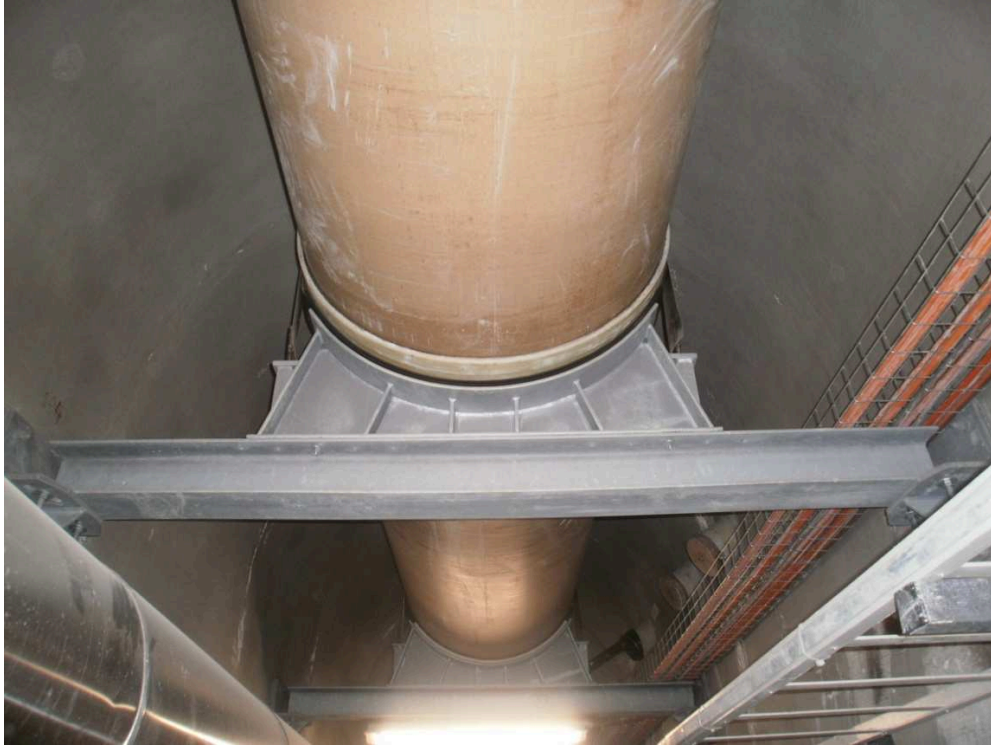
Obr. 6 Kanalizační potrubí DN 1400 (zdroj: vlastní fotodokumentace, Autor: Petr Jiráček)
