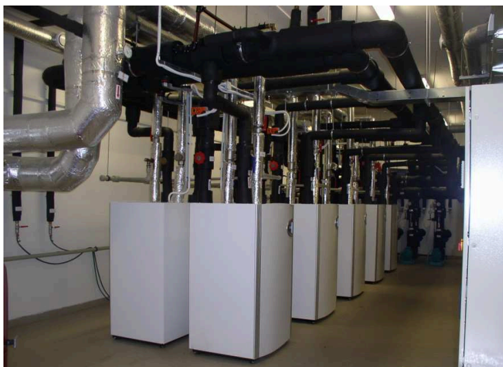
Obr. 20 Pohled na strojovnu desíti tepelných čerpadel (zdroj: http://www1.vsb.cz/ke/vyuka/tepelna_cerpadla/ )
