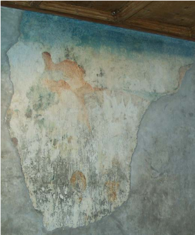
Abbildung 111: Rehtes Fragment an der Südwand, Zustand 2012.
