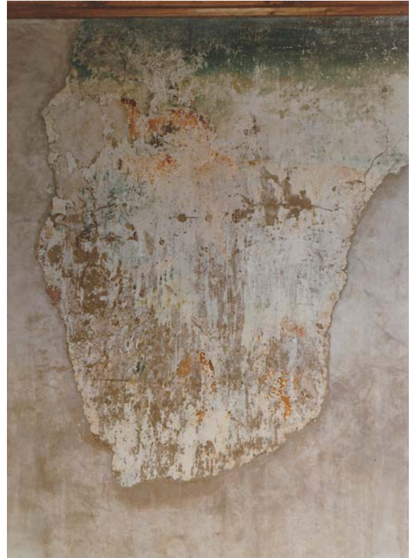
Abbildung 112: Rehtes Fragment an der Südwand, Zustand 1979.
