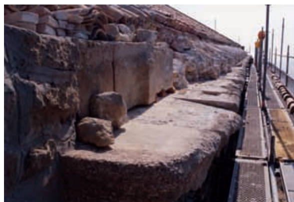
Arranque de torre norte y cornisa sin parte de tejas ni canalón, 2003
