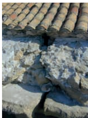
Hierro empotrado y grietas, 2003
