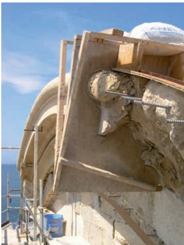
Fig 05c. Estado de la cornisa reconstruida del tímpano (ca. 2005)
