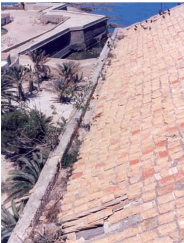
Fig. 05b. Estado del canalón y la cornisa antes de iniciar las obras (ca. 1998)
