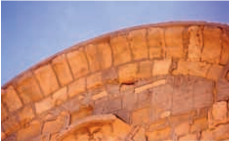
Estado inicial moldura fachada oeste ca. 1998
