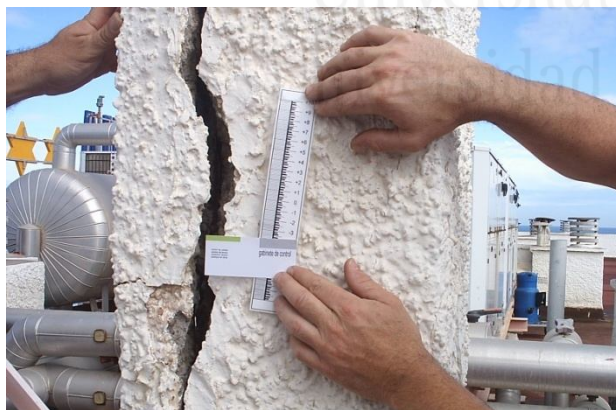
Fotografía n° 28 Corrosión por afección ambiental.
