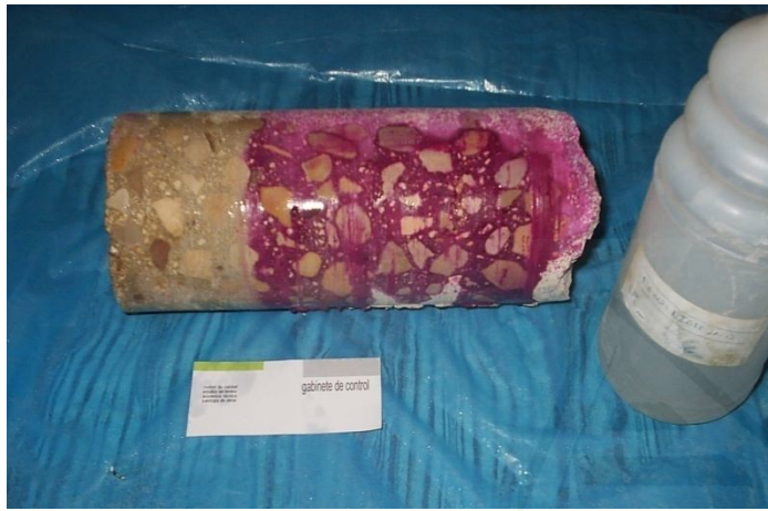
Fotografía n° 21 Profundidad de Carbonatación.
