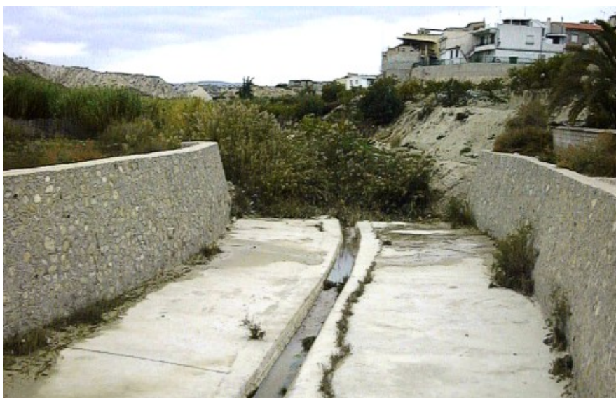
Figura 10. Canalización de la Rambla de Albudeite a su paso por esta localidad de Murcia.
