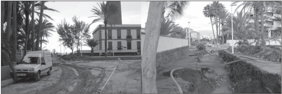
FIGURA 10. En la fotografía de la izquierda se muestran los lodos que quedaron tras evacuar el agua acumulada en la Plaza de Colón, que anegó el hotel situado en sus proximidades. En la fotografía de la derecha se muestra el canal que hubo de realizarse para permitir que las aguas salieran directamente al mar.
