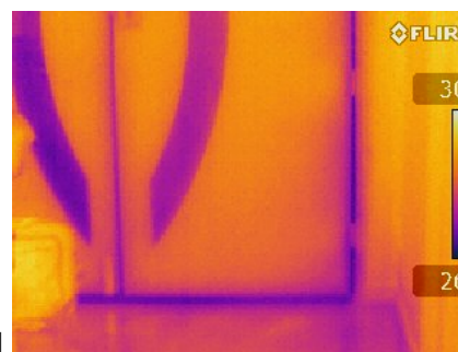
Fig (h): door leakage points
