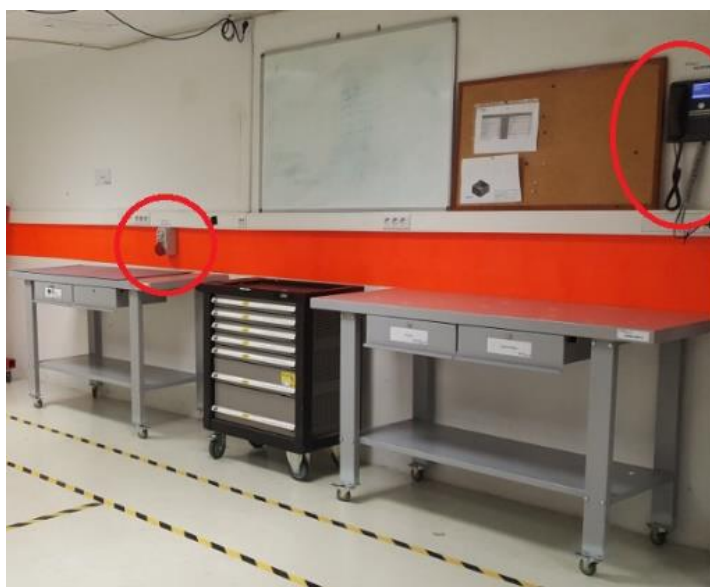
Figura 39 - Tomada trifásica e telefone
