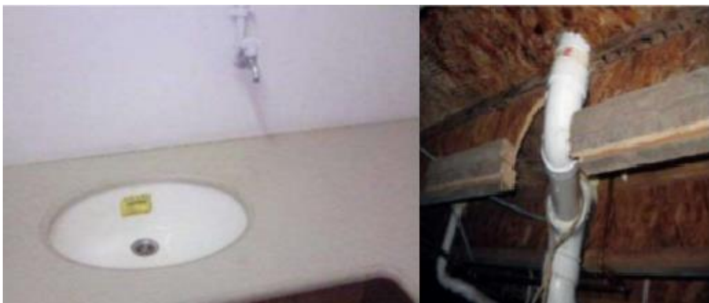
Figura 5.5 - Problemas típicos na construção, devido à falta de coordenação [37]
