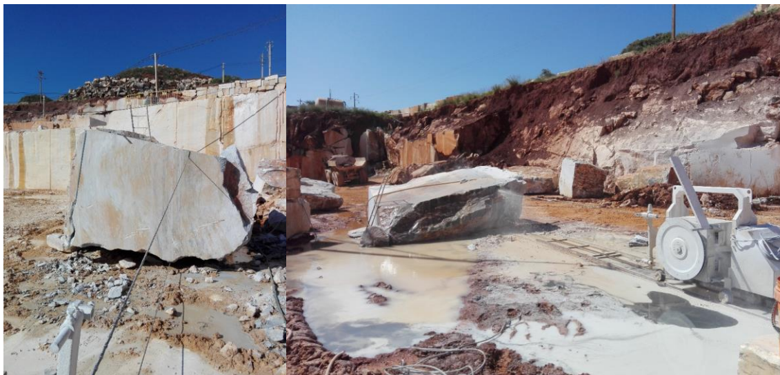
Figura 5-9 -Máquina de corte de fio diamantado a cortar blocos de mármore na pedreira.
