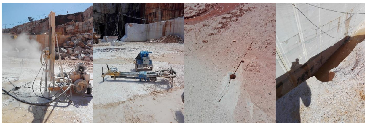
Figura 5-7 - Equipamentos usados na perfuração (o equipamento Jumbo à esquerda, para os poços mestres e alguma furação vertical e à direita, a perfuradora de fundo de pedra para furos horizontais). De seguida, o diâmetro obtido com o martelo e pneumático ligeiro e à direita, a perfuração vertical numa bancada através do Jumbo.
