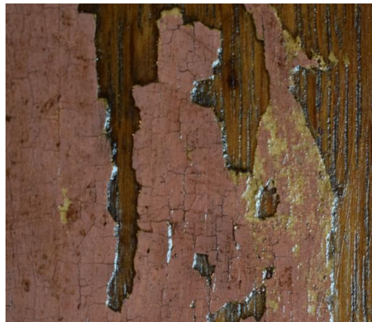
Figura 82 – Destacamento/Descoloração da parte superior da camada pictórica
