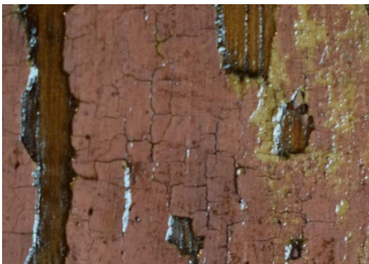
Figura 89 – Fissuras Mecânicas encontradas ao longo da pintura
