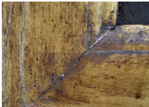
Figura 80 – Pequenos buracos causados por insetos na moldura
