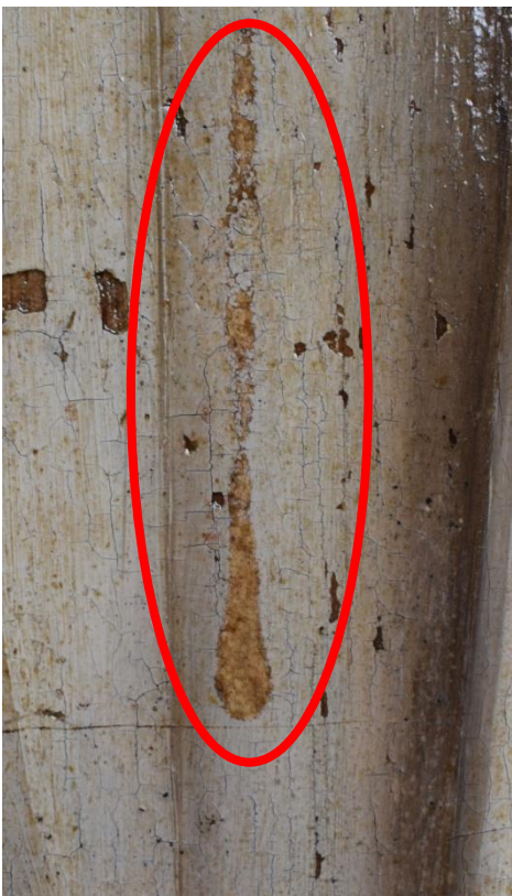
Figura 91 – Mancha de Sujidade
