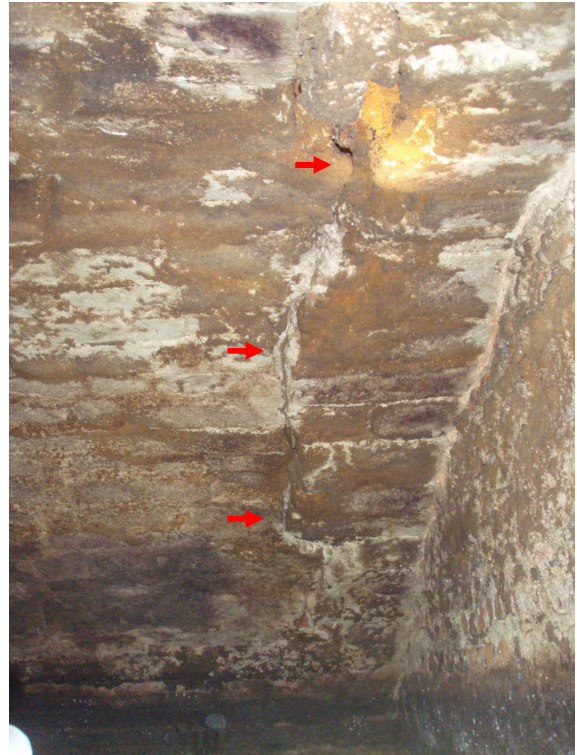
Foto 22. Recente doorboring van het oostelijk gewelf met een plastic rioolbuis. (Foto MoWa)
