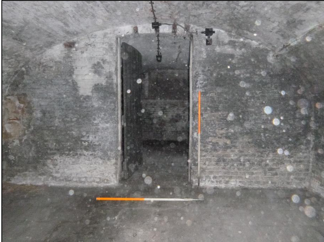
Figuur 18: Dubbele met elkaar verbonden kelderruimtes met verluchtingnissen langs de straatzijde (ABO nv)
