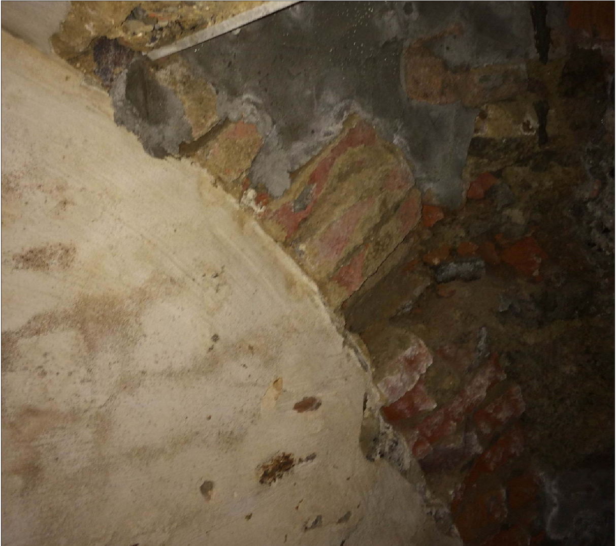
Figuur 16: foto genomen van het gewelf van de bestaande kelder. De gebruikte bakstenen en mortel komen overeen met deze uit de kelder die in de eerste proefput werd aangetroffen.
