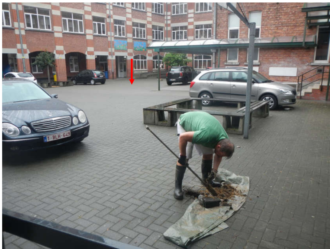
Afbeelding 2: De locatie van boring 5 in een mechanisch boorgat voor een peilbuis en boring 4 (rode pijl).
