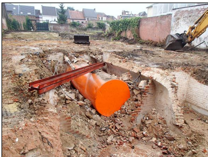
Figuur 36: De mazouttank.
