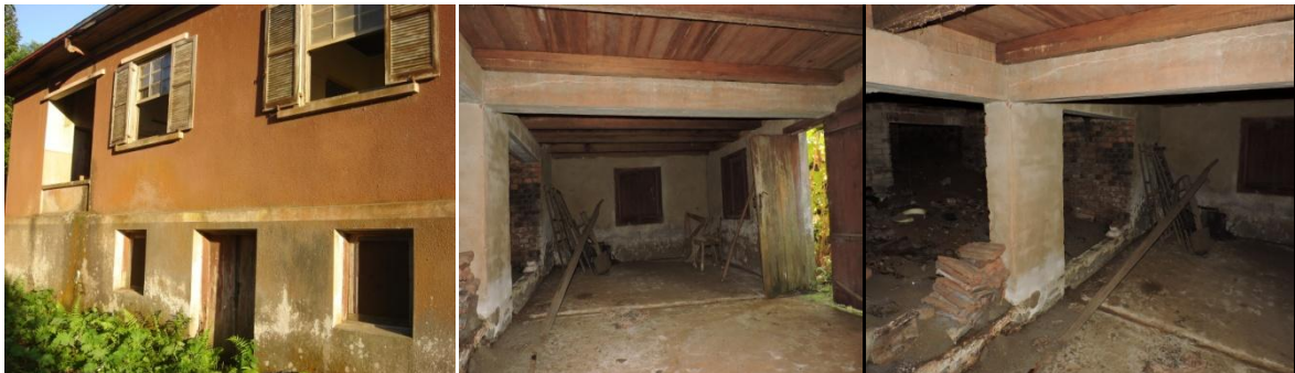
Figura 12: Vista da elevação que o porão proporciona a casa. Ao lado imagens do interior do porão
