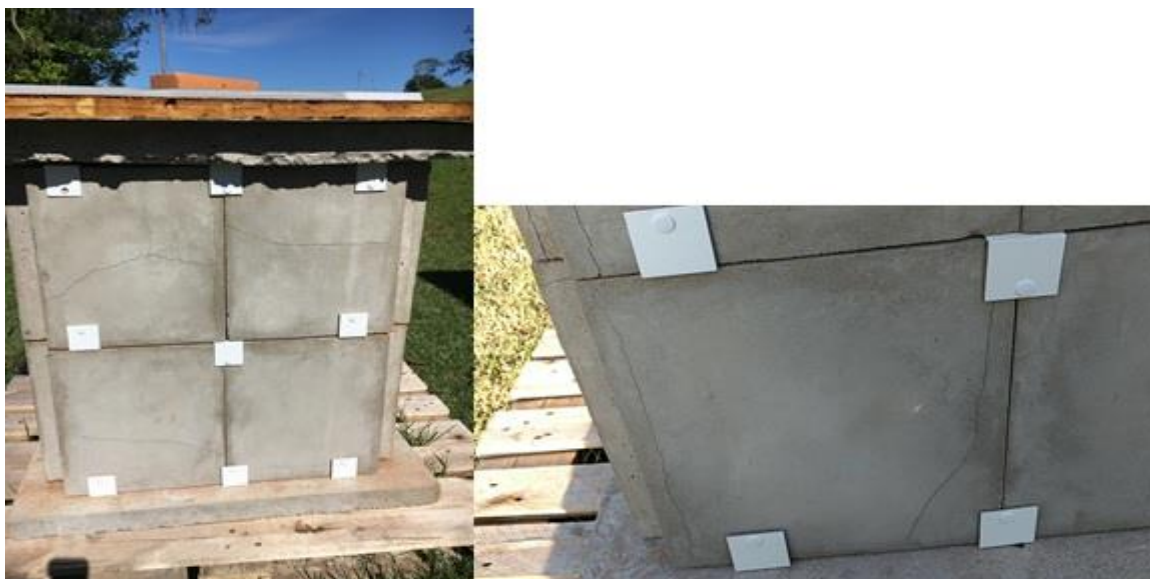
Figura 25 – Fissuração nas placas
