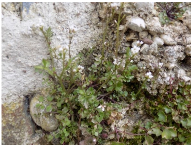
Slika 9: Cvetoča rastlina na razpokani zgradbi.
