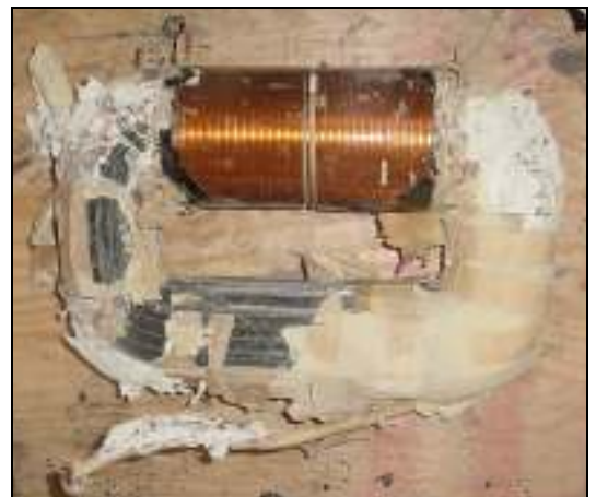
Foto 2 – Circuito magnético de un transformador de medición
