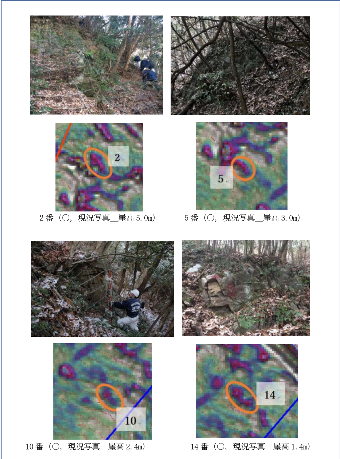
図 6.3.11 落石発生源抽出結果および現況写真 (エリア 2)
