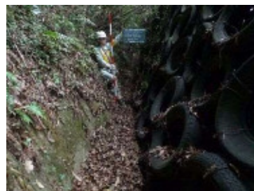
②擁壁背面の落石
