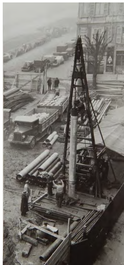
Fig. 5 (a destra): il cantiere per lo scavo di un pozzo per il prelievo dell'acqua potabile dal sottosuolo. Autore non identificato, stampa su carta, anni quaranta del Novecento. (Fondo fotografico storico Servizio Idrico Integrato MM SpA).
