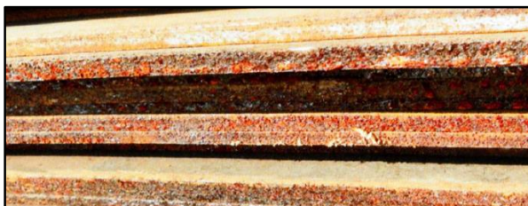
Abbildung 3-19 Korrosion an Blechen, Quelle: Verlag Stahleisen 2015, S. 97
