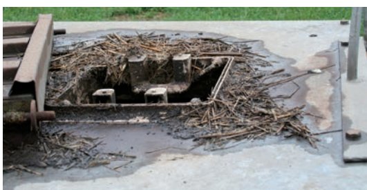
Ventilationsklap mangler. Ny skal monteres. Foto: Heidi M. Andersen
