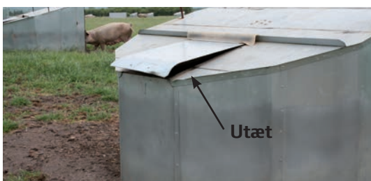
Ventilationsåbning skal repareres, kan ikke lukke tæt. Foto: Heidi M. Andersen
