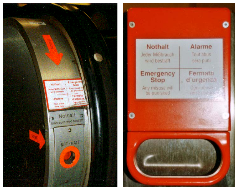
113 / 114 Nothalt-schalter an Rolltreppen des Frankfurter Hauptbahnhofs, 2005.
