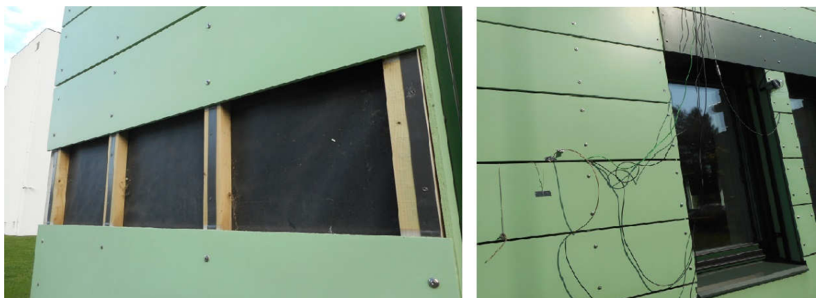
Obr. 25: Instalace měřícího zařízení Ahlborn
