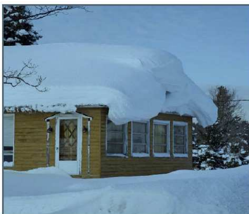
Obrázek 3.1 - Sníh na střeše [5]
