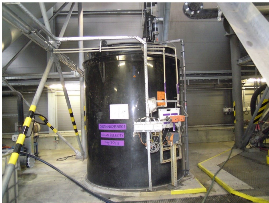
Obr. 6.1. Dávkovací nádrž koagulantu v SOS EMĚ [16]
