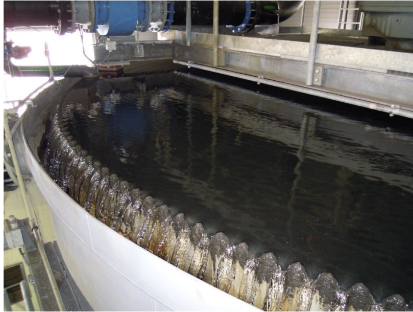
Obr. 5.4. Sedimentační nádrž – přepad čisté vody [16]
