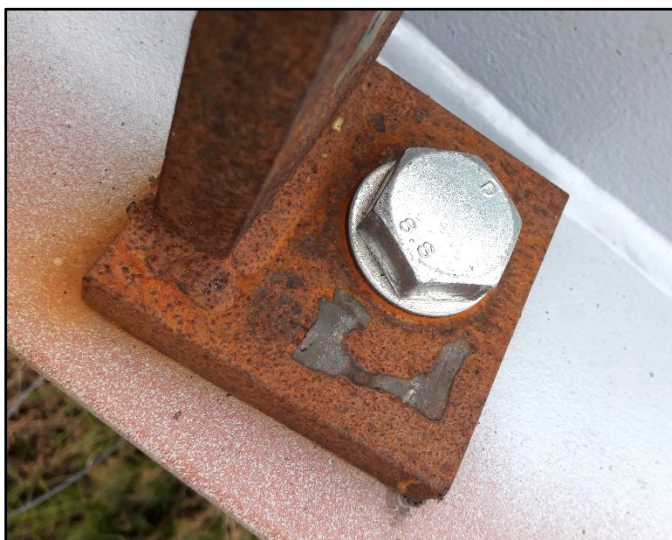
Obrázek 3 – Zkorodovaný přípravek s nerezovým šroubem
