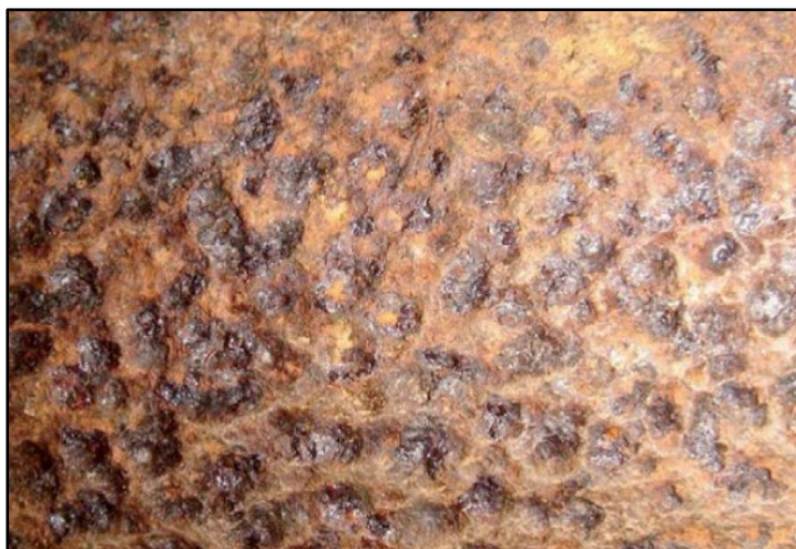
Obrázek 11 – Detail důlkové koroze 19
