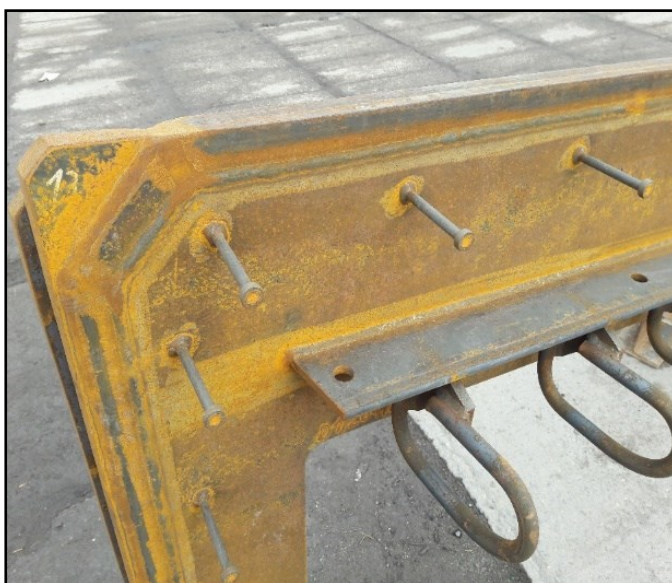
Obrázek 4 – Příklad praktické koroze na dilatačních závěrech
