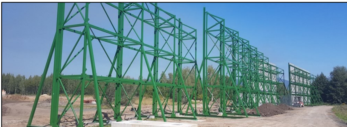
Obrázek 2 – Povrchově upravená protihluková stěna, společnosti IZOSTAV 1
