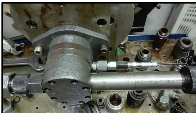
Obr. 2.2 - Umístění tlakového snímače v tělese čerpadla
