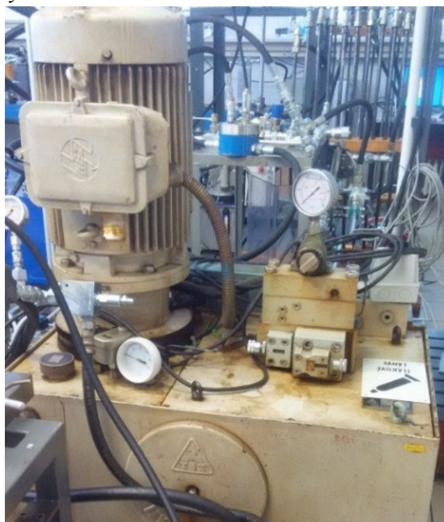
Obr. 7.1 Foto hydraulického agregátu
