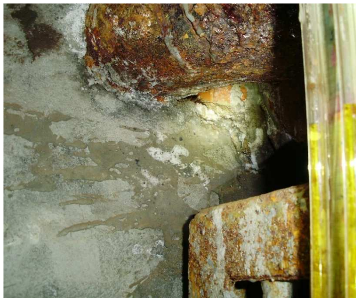
Obr. 4.15: Korodující kontrolní potrubí hráze č.: 04036 v jámě Je-1. [5]
