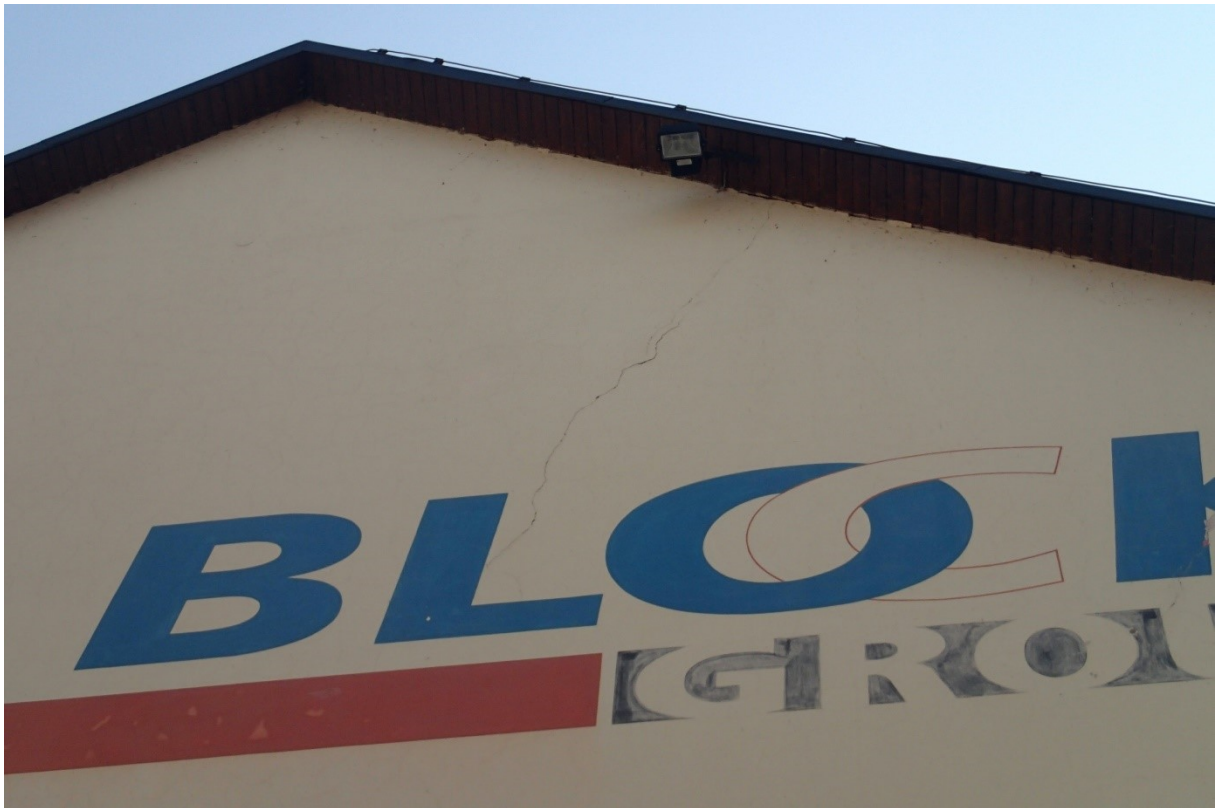
Obrázek 8: Trhlina na objektu nacházející se v koruně svahu.
