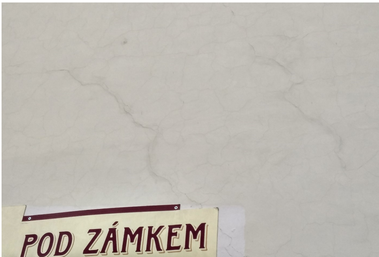
Obrázek 9: Trhliny na objektu.
