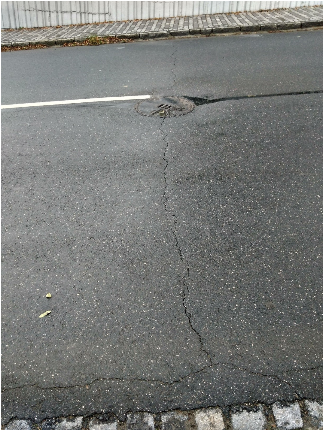
Obrázek 10: Trhliny na pozemní komunikaci.
