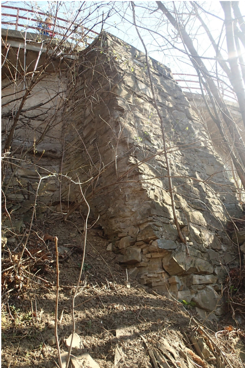
Obrázek 12: Opěrná zeď pod parkovištěm.
