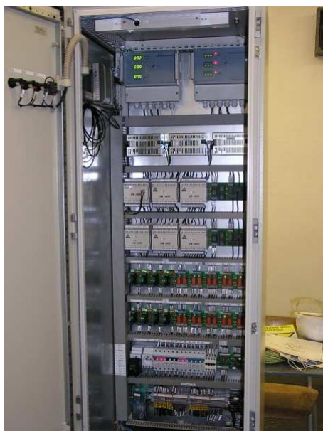
Obrázek 4. Přijímače HDO a elektroměry složené v kabinetu
