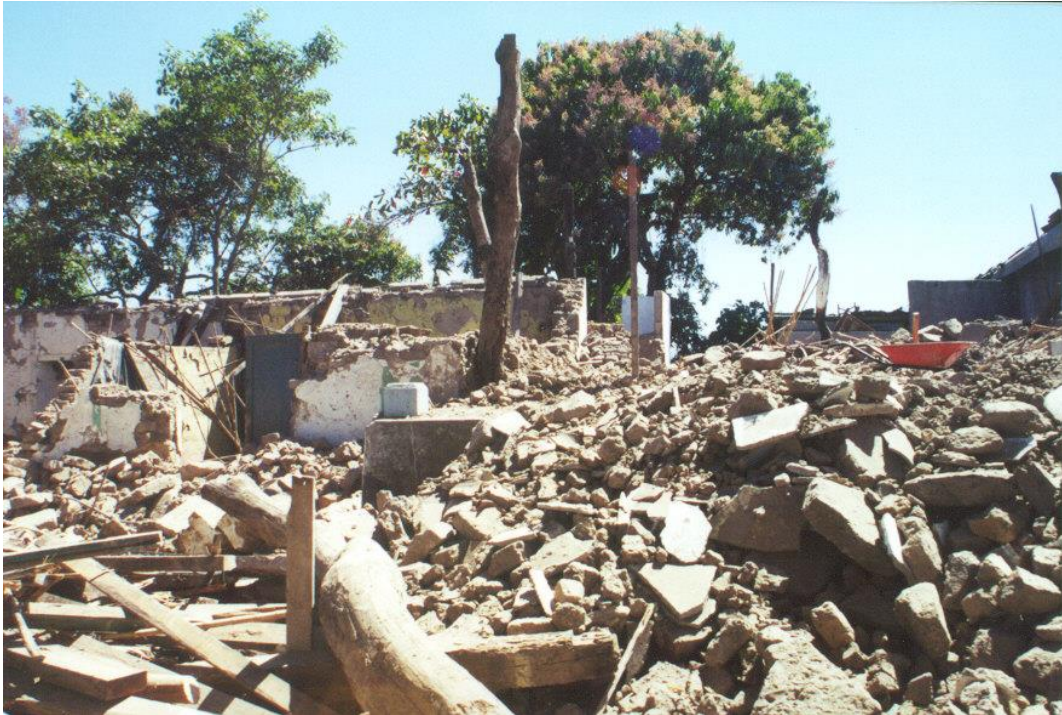
Figura 123. Colapso de vivienda de adobe, El Carmen, Cojutepeque, depto. de Cuscatlán, terremoto del 13 de febrero de 2001. Cortesía de Dr. Manuel López. [1]
