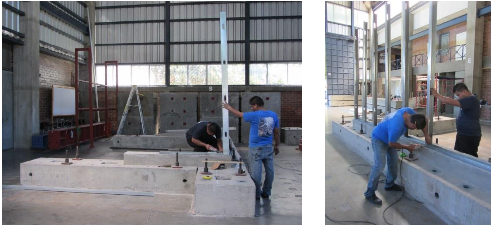
Figura 159. Fijación de los perfiles verticales de la Pared 1 al Perfil de Anclaje.
