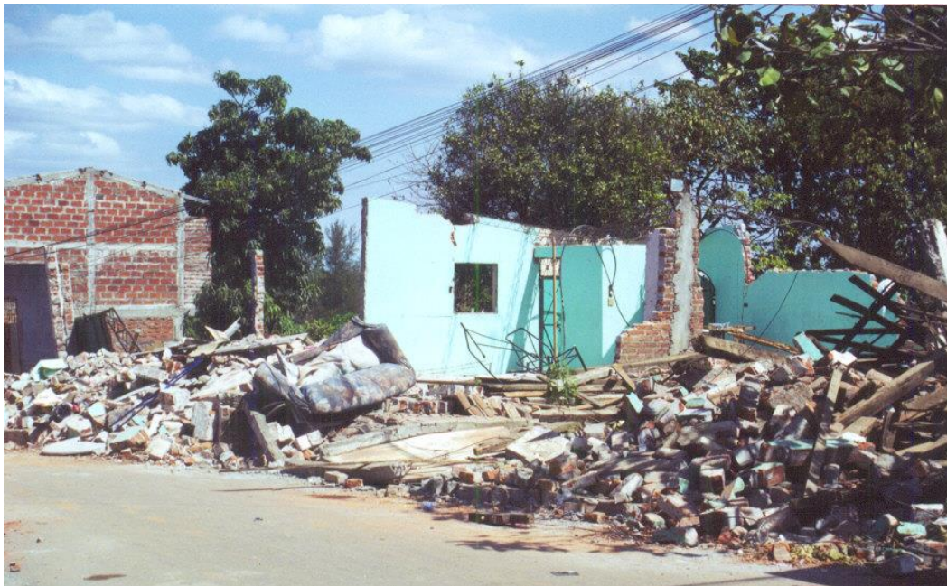
Figura 124. Colapso de vivienda de mampostería confinada, Armenia, depto. de Sonsonate, terremoto del 13 de enero de 2001. Cortesía de Dr. Manuel López. [1]
