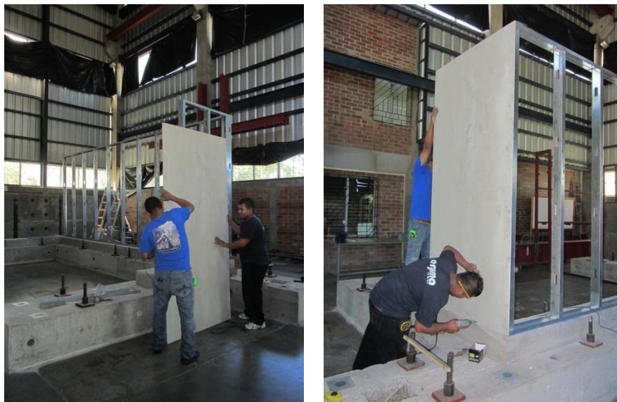
Figura 162. Fijación de las láminas de fibrocemento a las retículas de las paredes.
