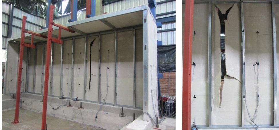
Figura 194. Colapso de la fisura G2 en la cara este de la pared 1.
