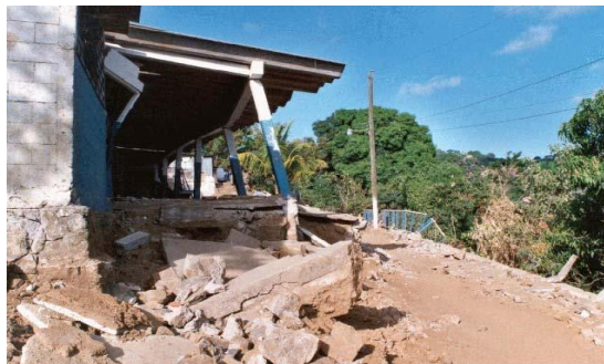
b. Colapso de pórtico exterior. Escuela el Limón.
