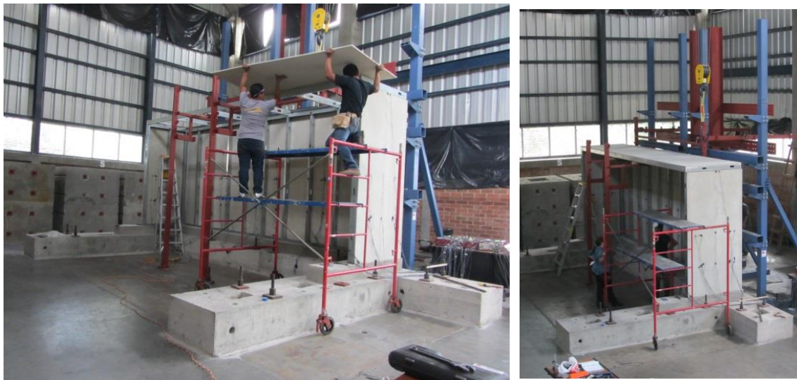
Figura 166. Colocación de las láminas de fibrocemento de la estructura del techo y vista del modelo completo.
