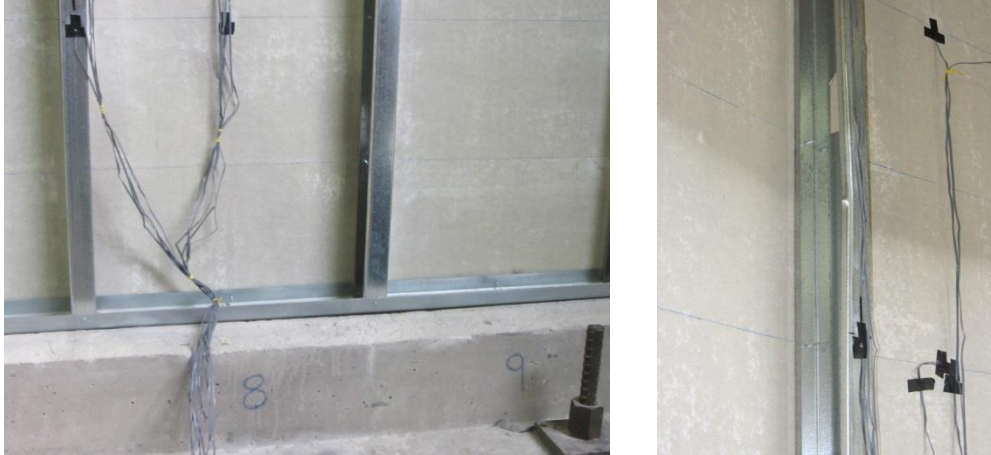
Figura 196. Deformaciones permanentes experimentadas por distintos perfiles de la estructura después del colapso de la lámina de fibrocemento.
