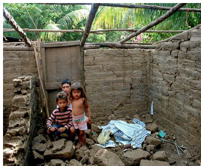
a. Interior destruido escuela El Limón.
