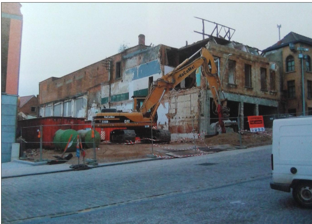
Figuur 30. Foto van de afbraak van het Volkshuis en het aanpalende winkelpand van de S.M. De Verbroedering, 9 oktober 2004. Bron: DE RO & SURDIACOURT, Het Schoonste Spektakel , p. 204
