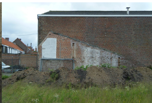
Fig. 33: Restanten van het afgebroken gebouw op de gevel van het aanpalende gebouw
