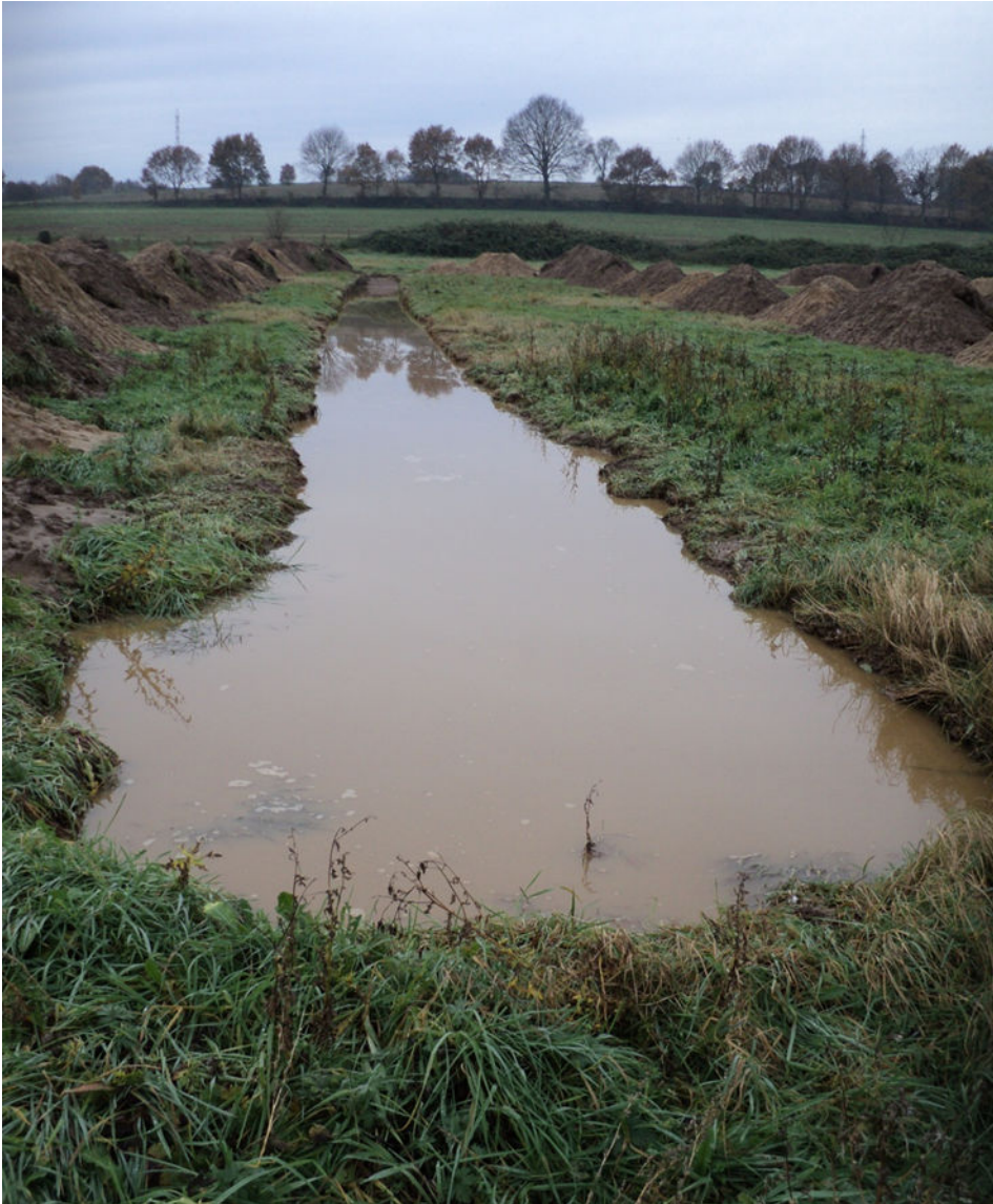
Figuur 17. Onder water gelopen werkput na een wolkbreuk. (Foto Triharch ©)
