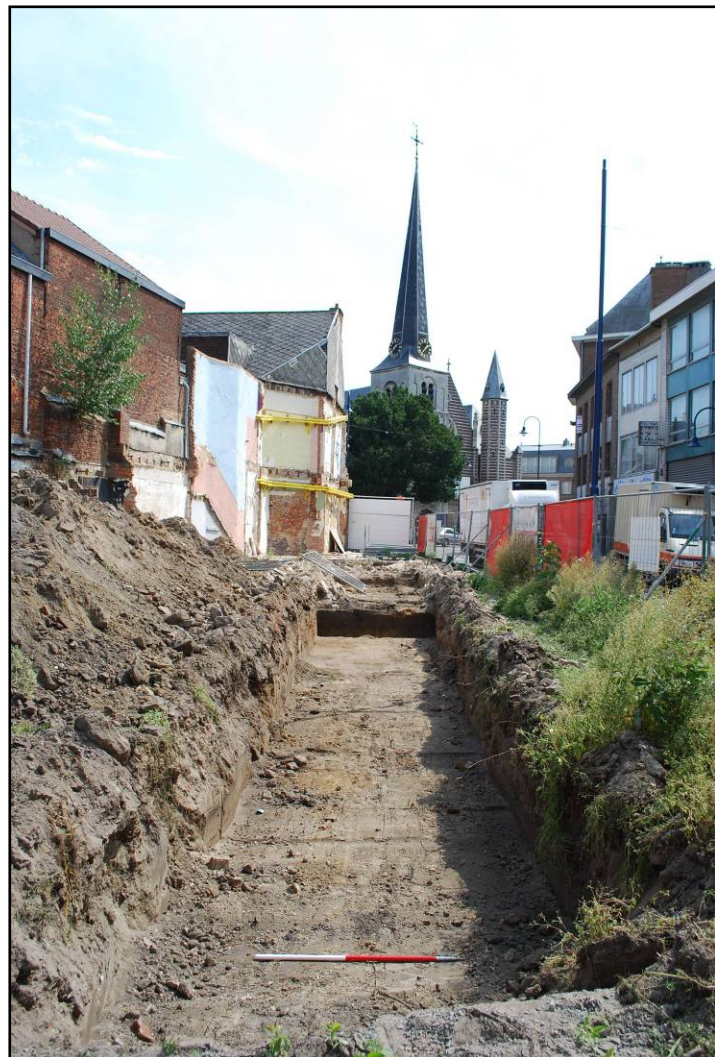
Fig. 8: Zicht op de sleuf in de richting van het Gemeenteplein. (Foto: ARON bvba)
