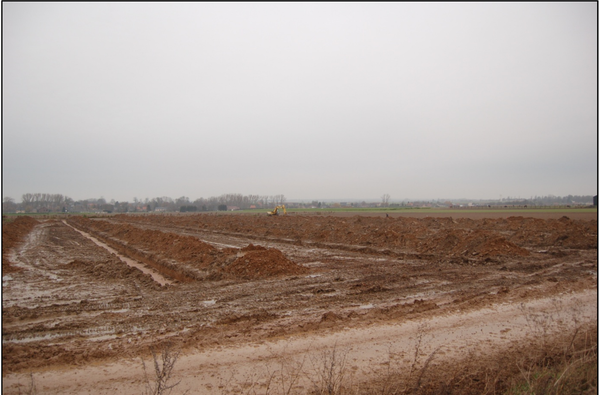
Fig. 10: Aanleg van de laatste vijf sleuven in januari 2008 na het ontgooien van de bodem (Foto: ARON bvba)
