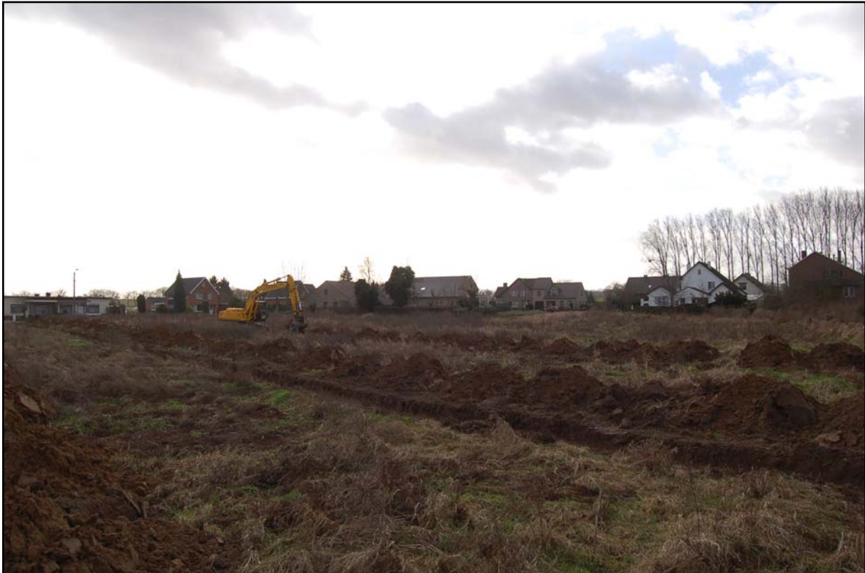
Fig. 10: Perceel 708B, gezien vanuit de noordoostelijke hoek tijdens het aanleggen van de sleuven. Foto in de richting van de Linnerveldstraat (foto: ARON bvba)
