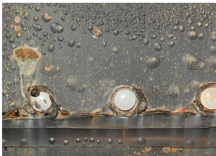
Abbildung 153: Detailaufnahme der Blasenbildung bei der Beschichtung Painted Epoxy an der Demonstratorinnenwand
