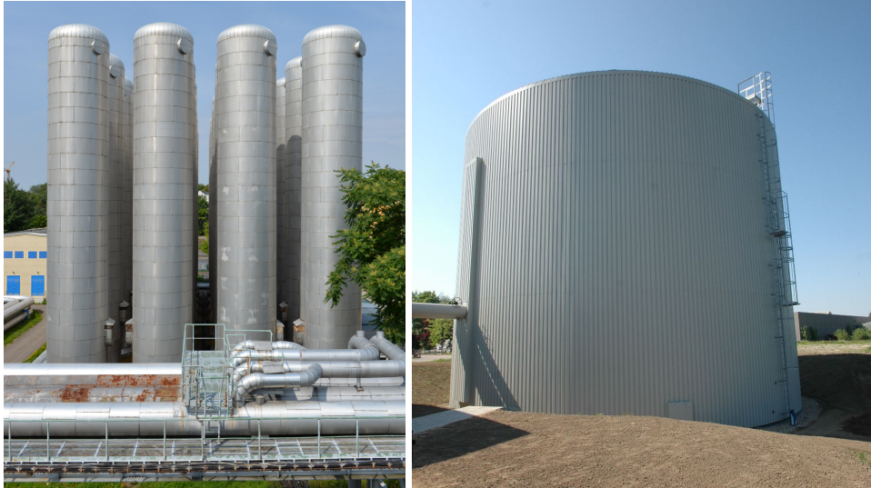
Abbildung 3: Heißwasserspeicher 6480 m 3 (links), Planung 160 °C, 22 bar, Integration in die Primärtrasse, Chemnitz, Fernwärme mit KWK, Betreiber inetz/eins [8], Warmwasserspeicher 2000 m 3 (rechts), Ein-Zonen-Speicher, solares Nahwärmesystem Braedstrup (Dänemark), Betreiber Brædstrup Fjernvarme [9]
