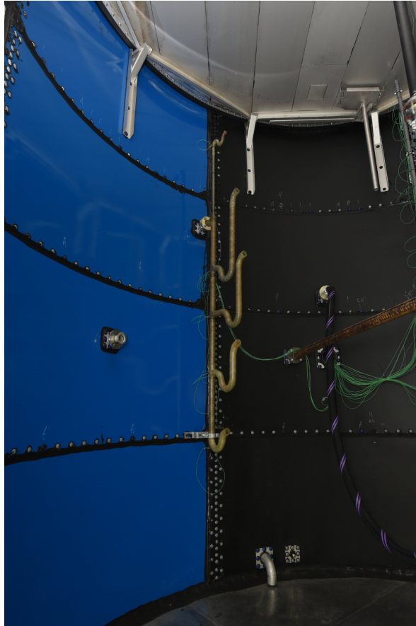
Abbildung 131: Demonstrator, Speicherraum, Speicherwand mit Schichtenlader (BES3), 09.02.2017
