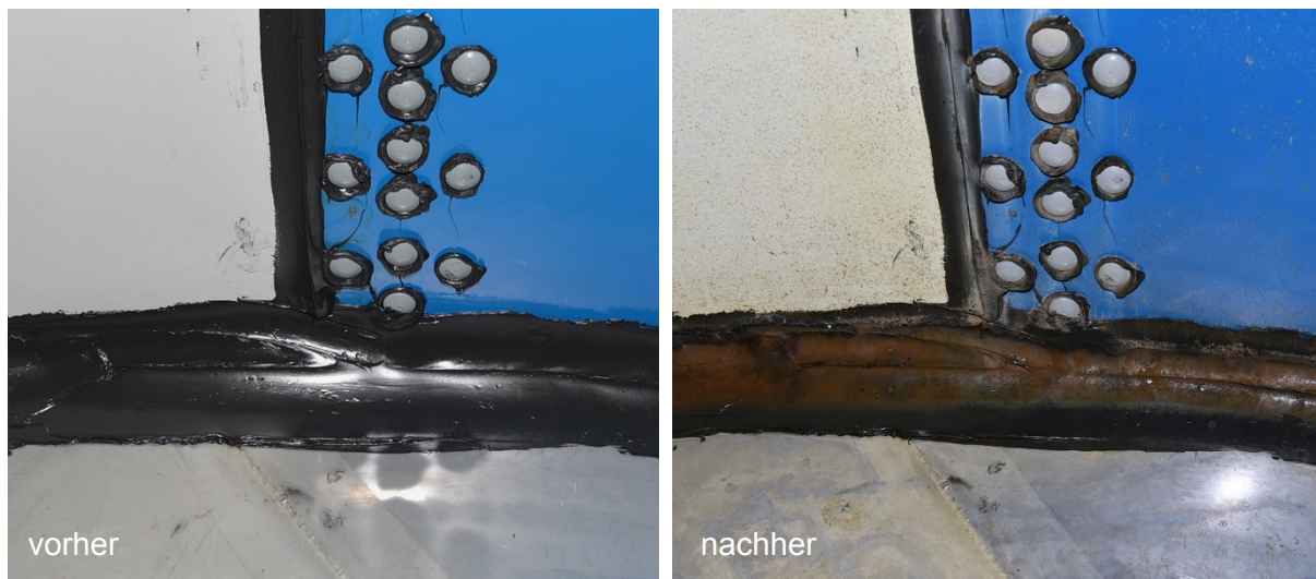
Abbildung 155: Vergleich einer Dichtnaht zwischen dem Bodenblech und zwei Wandsegmenten am Demonstrator vor Erstbefüllung und nach ca. einjährigem Betrieb (Wandsegmentmaterialien: Proguard CN200 und Fusion V1100)
